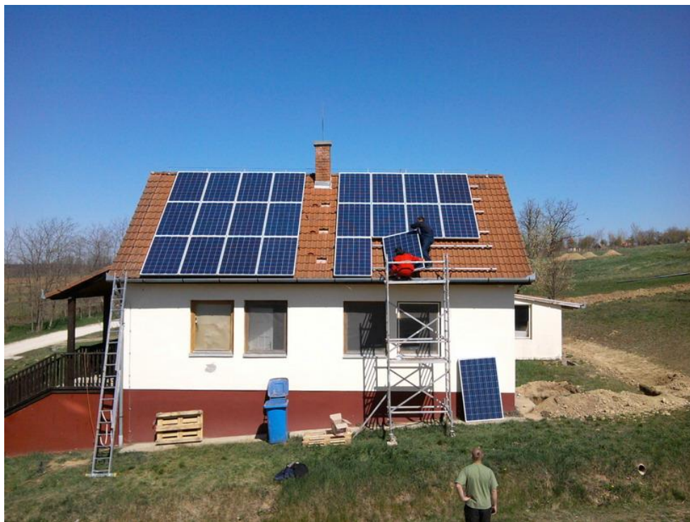
136. kép Napelem-telep bővítés (fotó: Öko-völgy Alapítvány)
